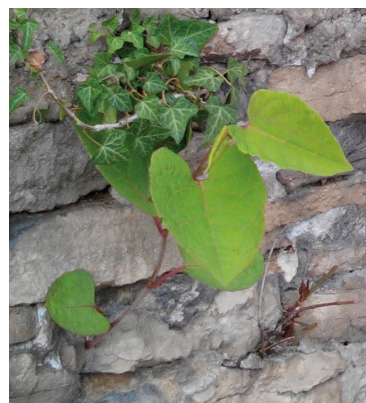
Tige de renouée traversant un mur.
